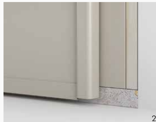
1 La posa è stata fatta a filo interno con una cassamatta B, quindi la soglia di battuta deve sporgere 10 mm verso l'interno per riportare il piano di battuta.
